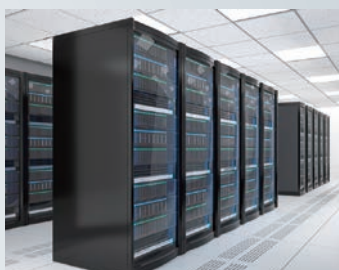
支持大容量通信的数据中心
