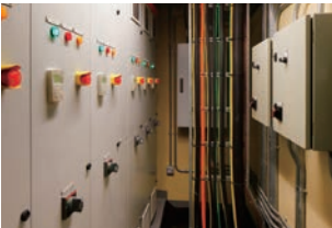
电源设备的定期检查、电能质量的监测 功耗的把握
